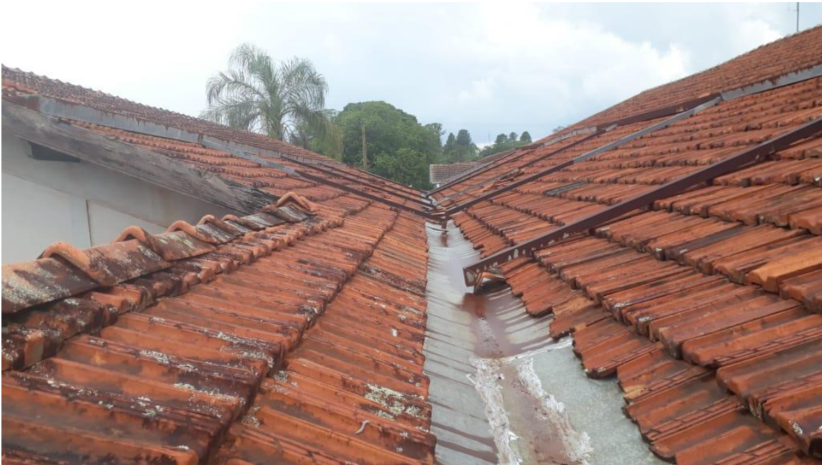
Águas e calhas
