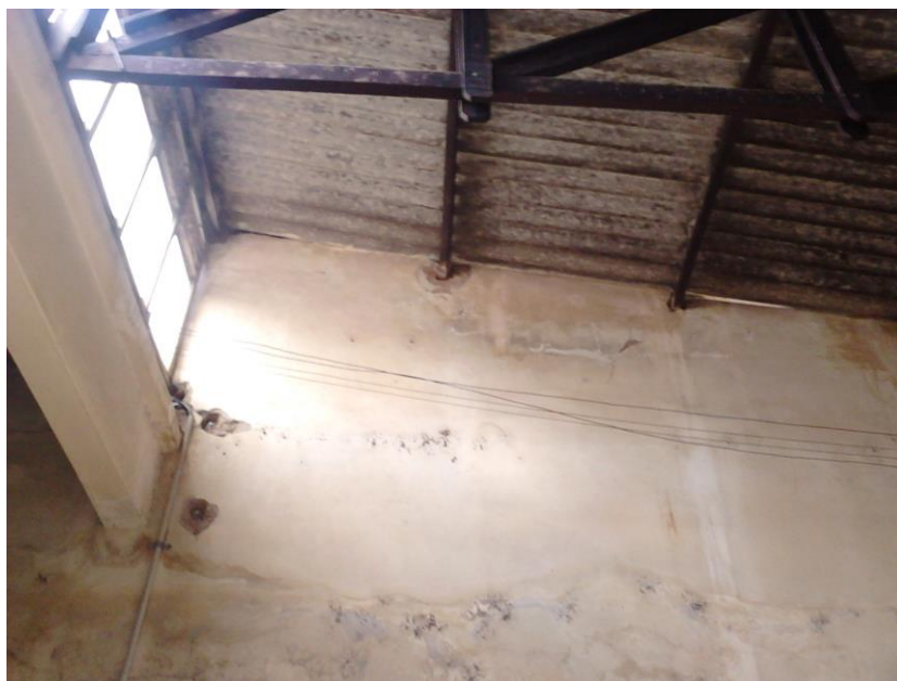
Foto 06: detalhe do apodrecimento das pontas do madeiramento
