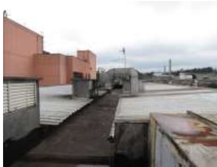
Foto 06 Cobertura 1 com telhas metálicas a ser substituída
