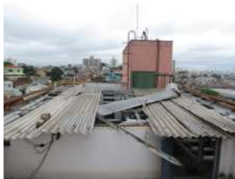
Foto 08 entre Cobertura 1 e 2 com telhas metálicas soltas
