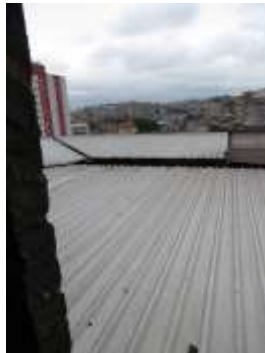
Foto 07 Cobertura 2 com telhas metálicas a ser substituída
