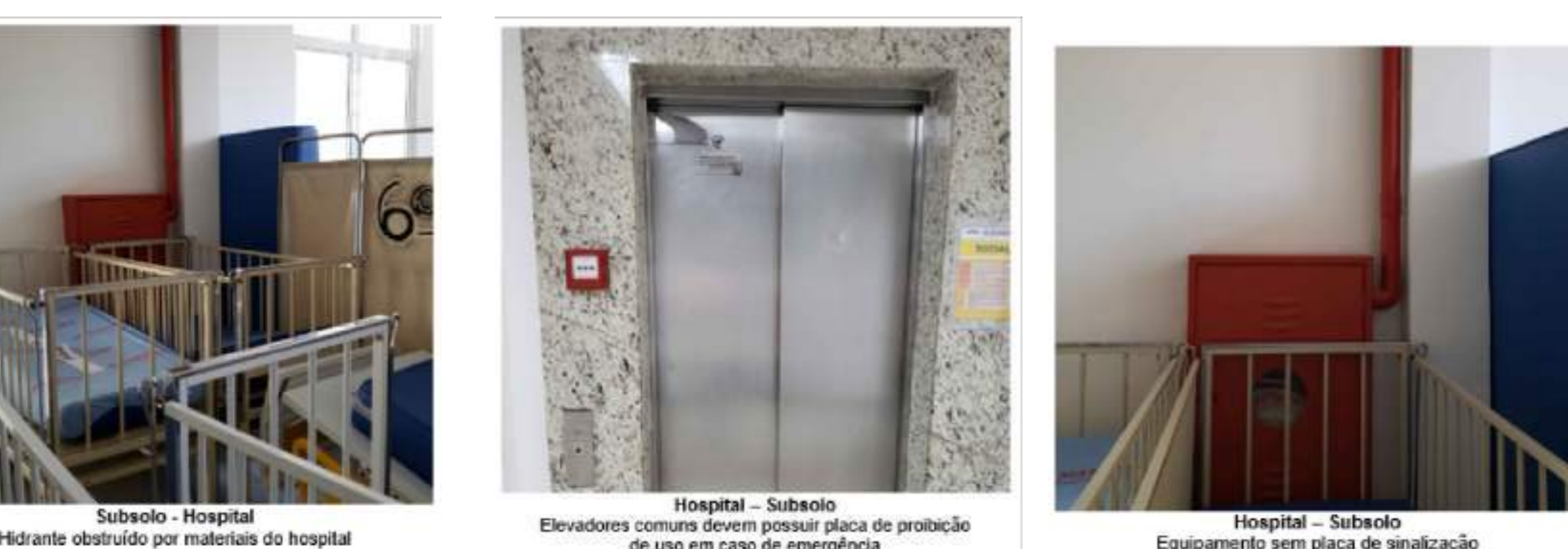
Sabão - Hospital Hidrante obturado por materiais do hospital Hospital - Sabão Elevadores com uso de placa de produção de uso em caso de emergência Hospital - Sabão Equipamento sem placa de sinalização
