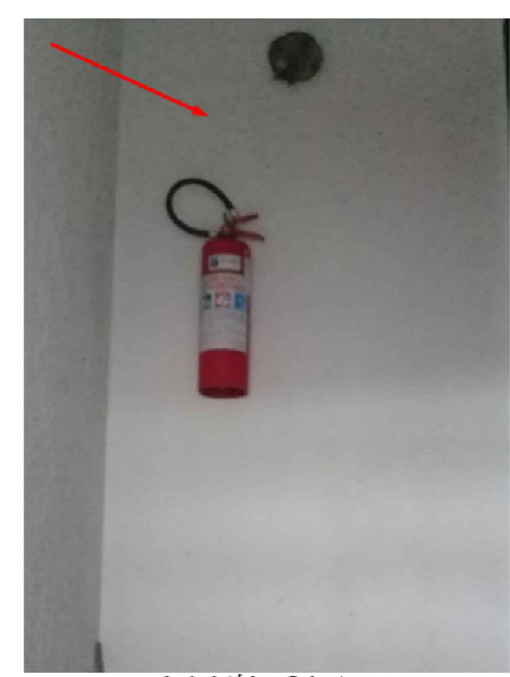
Ambulatório - Cobertura Prever sinalização de identificação do equipamento de incêndio.
